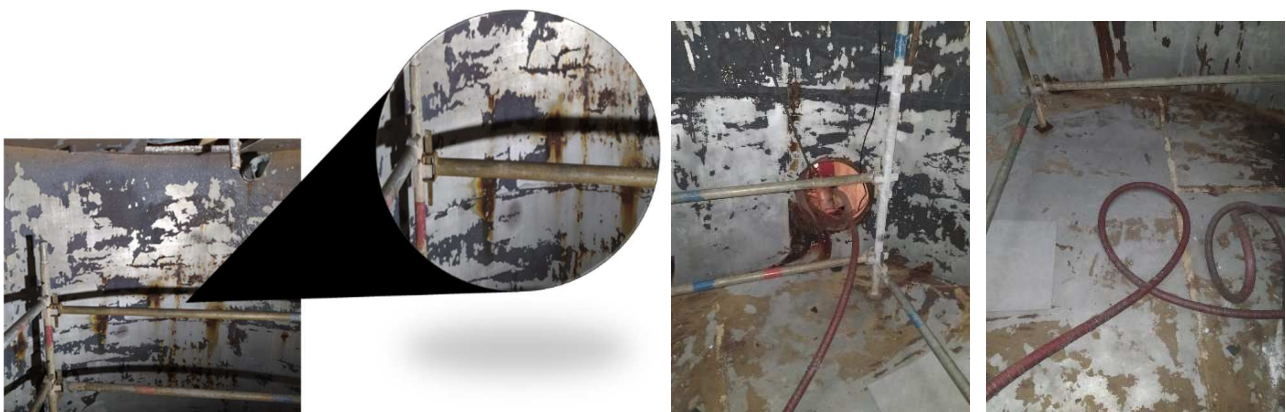
FOTOS DO TANQUE COM CORROSÃO
